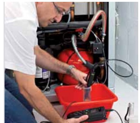
Analyse des Heizungswassers.
