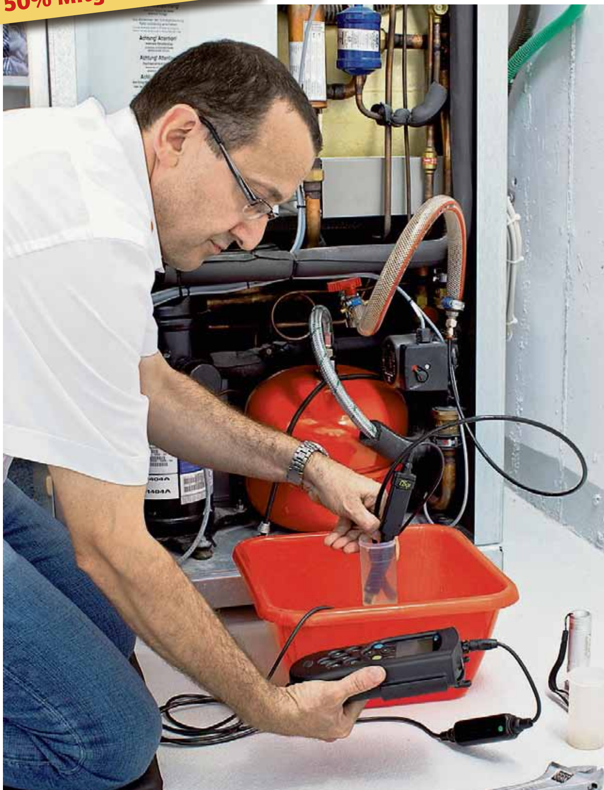
Ein Berater der Firma LSE-System bei der Zustands- und Wasseranalyse.
