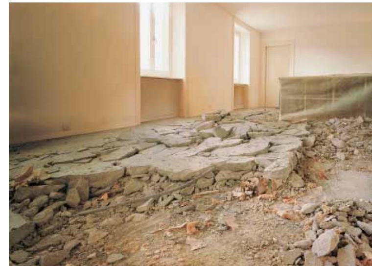
Solche Bilder gehören der Vergangenheit an: Ein Aufreißen der Böden ist bei einer Sanierung mit dem HAT-System nicht nötig.
